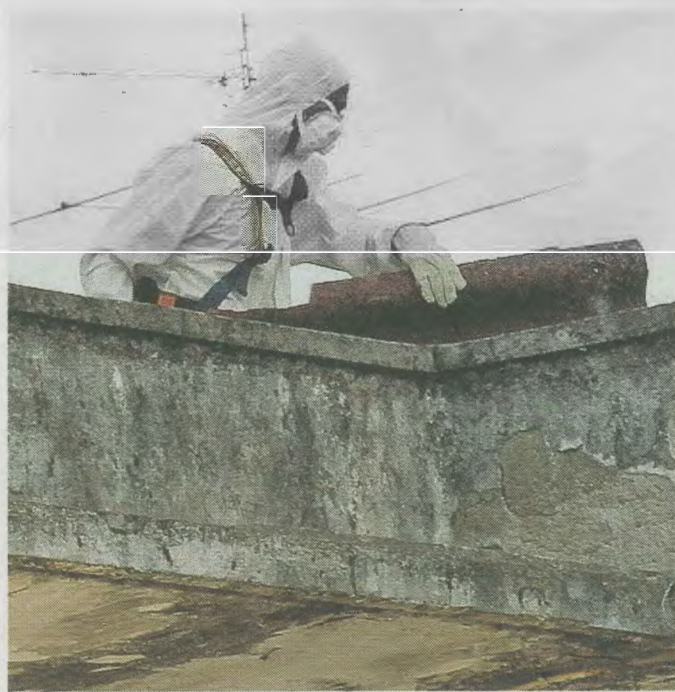
Smaltimento Entro fine anno devono essere rimosse le coperture in amianto
