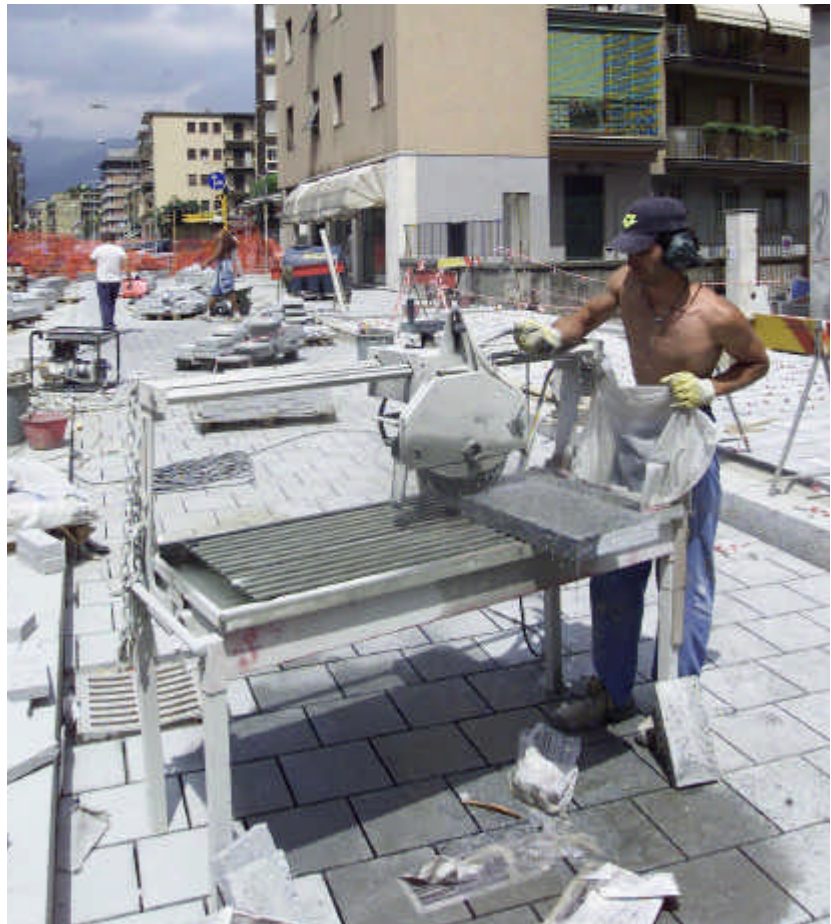
La stesura della pavimentazione in un tratto delle "linee" del progetto Lam
