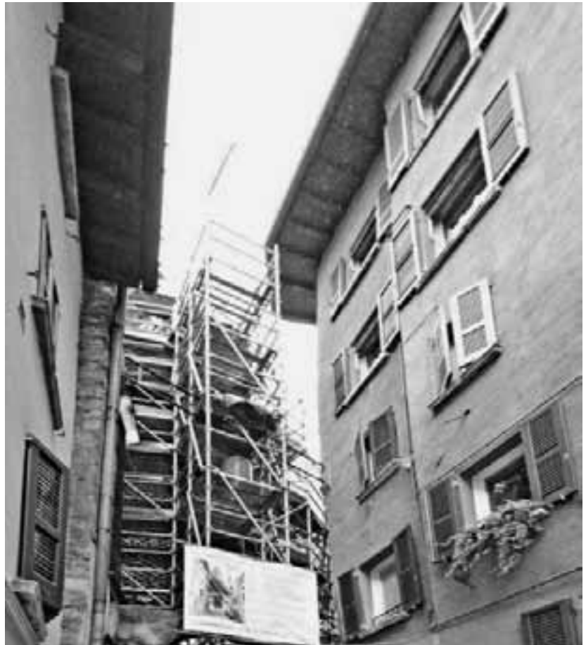
Le impalcature installate per procedere al restauro della chiesa di Santa Rita
