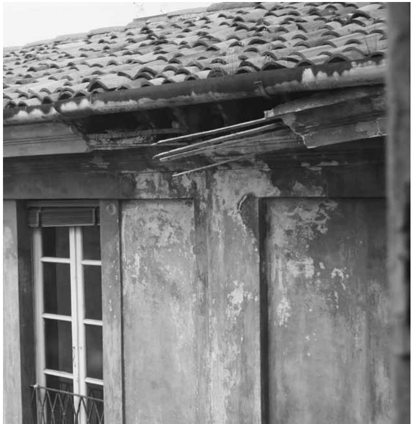
La foto mostra chiaramente lo stato di degrado dell'edificio
