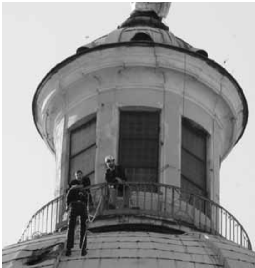
Sopralluogo dei tecnici per verificare i danni alla cupola di Santa Maria della Pace
